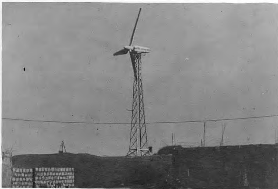
Fig. 103 — Parque eólico da Praia, Santiago
