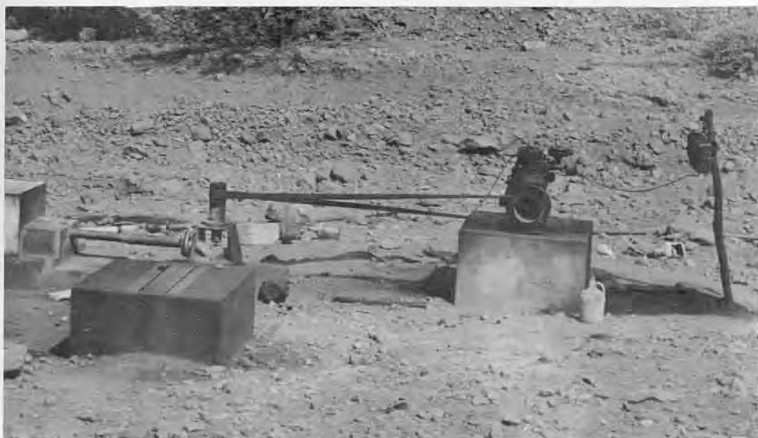
Fig. 91 — Furo equipado com motobomba, São Martinho, Santiago
